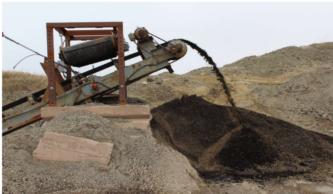
Figure 23. Convoyeur aimanté installé sur le convoyeur de sortie de la benne de mélange
